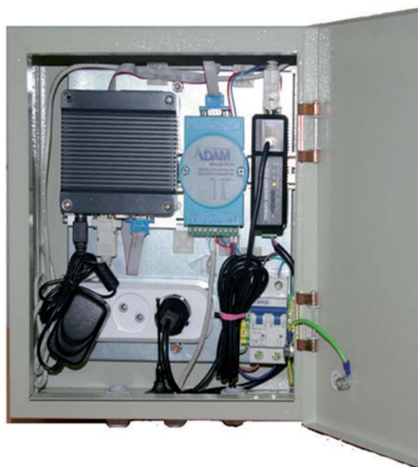
Шкаф учета Метроника MC-2405 с установленным внутри УСПД RTU-3255
